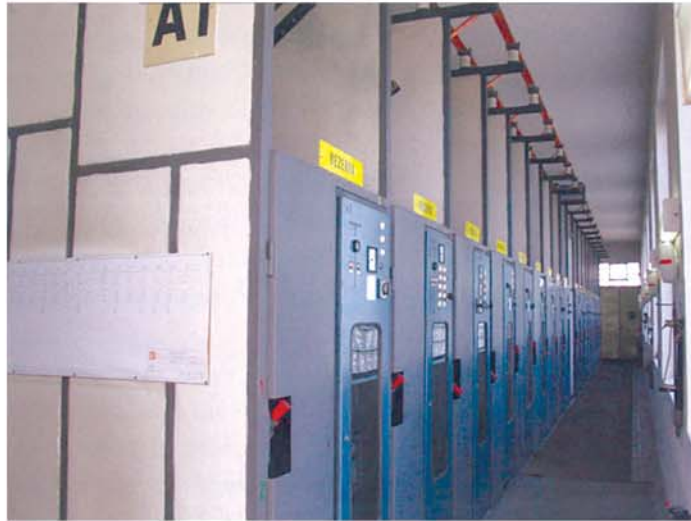
شکل ۶-۹- تابلوهای فشار متوسط پست فوق توزیع (منبع: شرکت برق CEZ)
